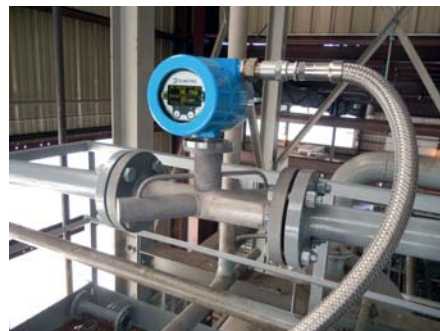
Ультразвуковой газовый расходомер «ЭлМетро-СГУ», на базе DSP-технологий, установлен на отходящих газах НПЗ в Западной Сибири
